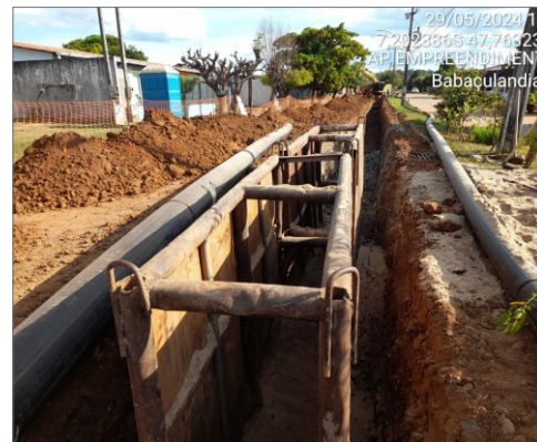
2ª fase da obra de implantação do sistema de esgotamento sanitário de Babaçulândia
